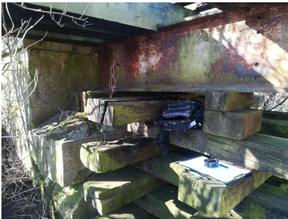
Fot. 3. Widok na przyczółek od strony Skowronna i podporę tymczasową. Widoczna korozja stalowych elementów przęsła, odspojenie fragmentu przyczółka oraz korozja biologiczna drewna.
