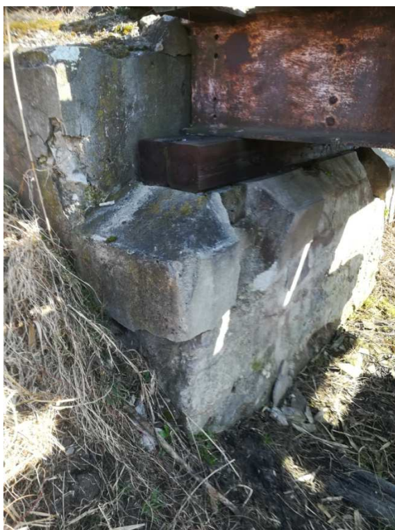
Fot. 5. Widok przyczółka od strony Umianowic. Widoczne odspojenie narożnika od strony dołu rzeki.
