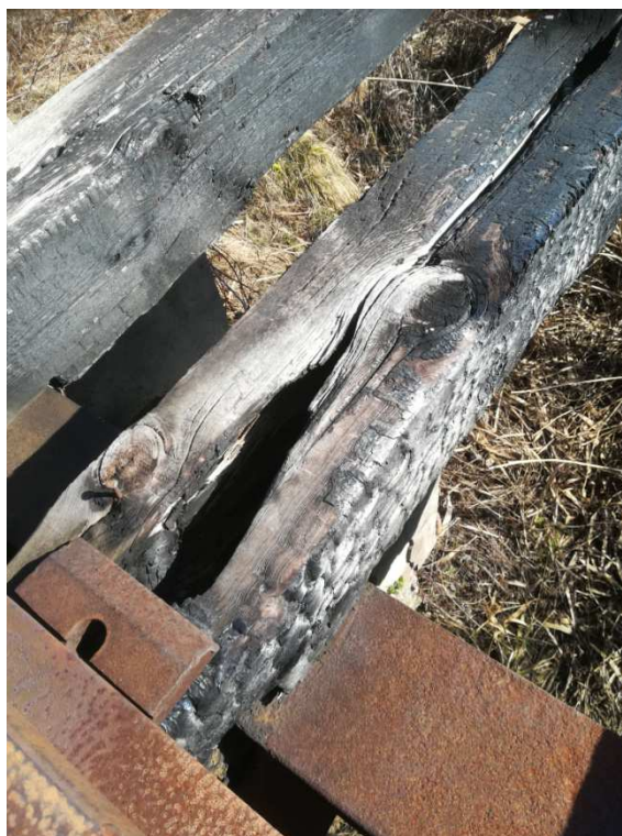
Fot. 7. Widok uszkodzonego (nadpalonego) podkładu od strony Umianowic.
