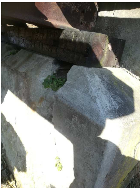
Fot. 6. Widok przyczółka od strony Umianowic. Widoczne odspojenie narożnika od strony góry rzeki i wegetacja roślinna.
