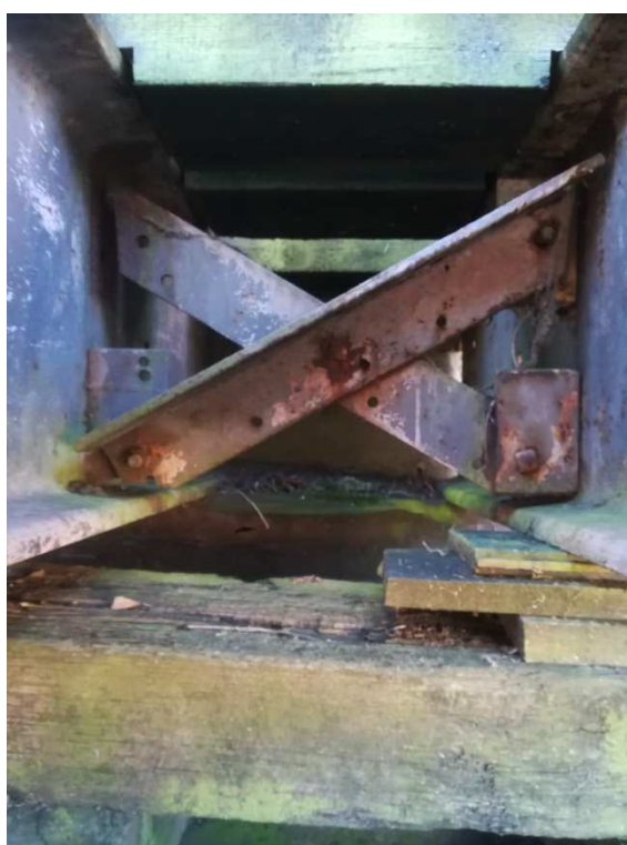
Fot. 4. Poprzecznicę/stężenie pomostu nad przyczółkiem od strony Skowronna. Widoczna korozja elementów konstrukcji stalowej.
