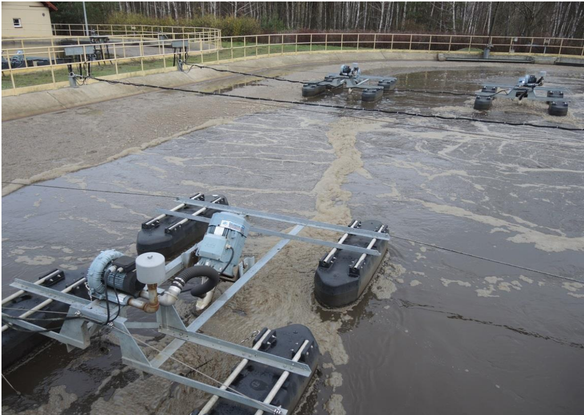
Fot. nr 6 Komory osadu czynnego
