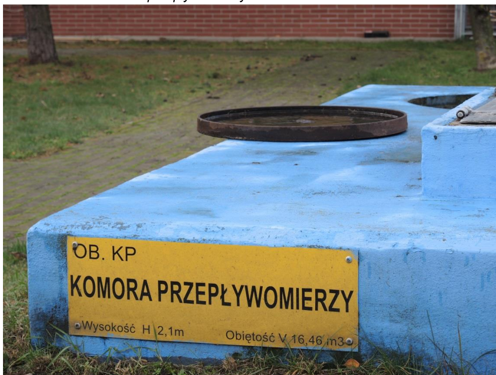
Fot. nr 4 Komora przepływomierzy
