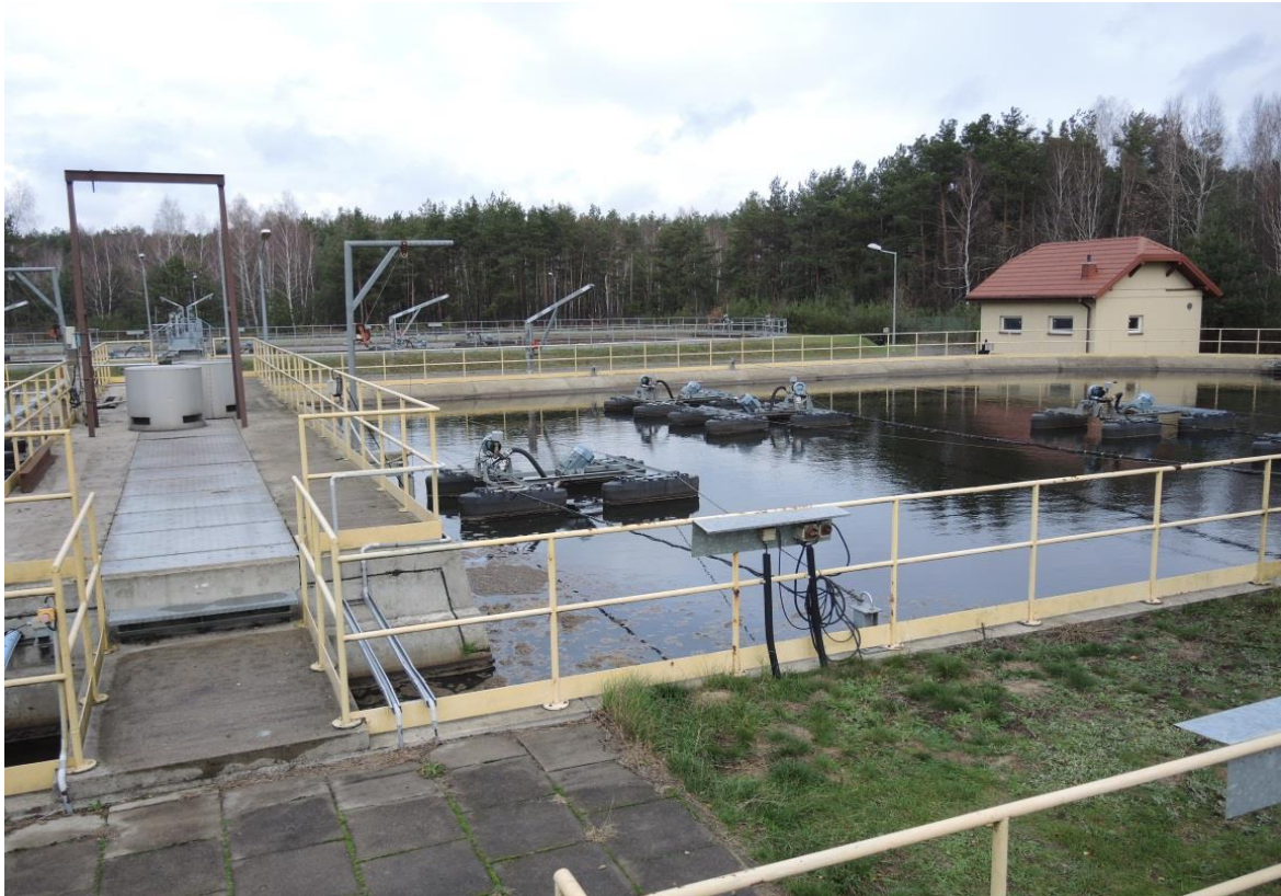
Fot. nr 7 Komory osadu czynnego
