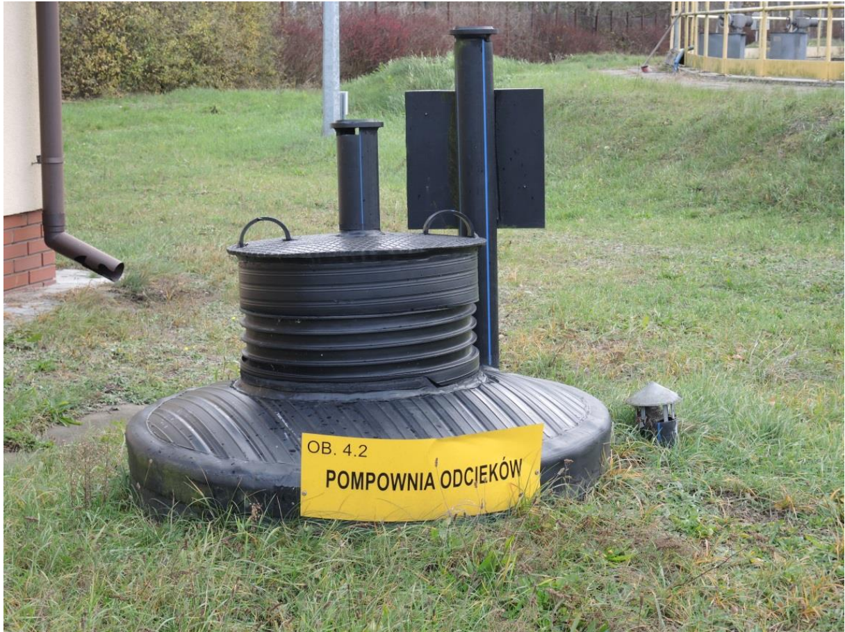
Fot. nr 14 Pompownia odcieków
