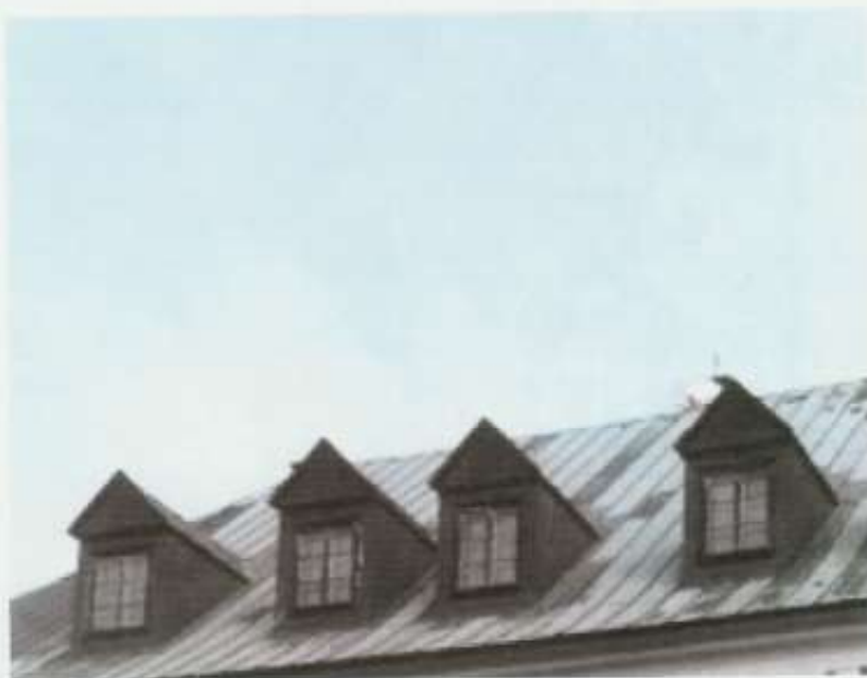
Załącznik nr 2 – stan stolarki okiennej przewidywanej do wymiany
