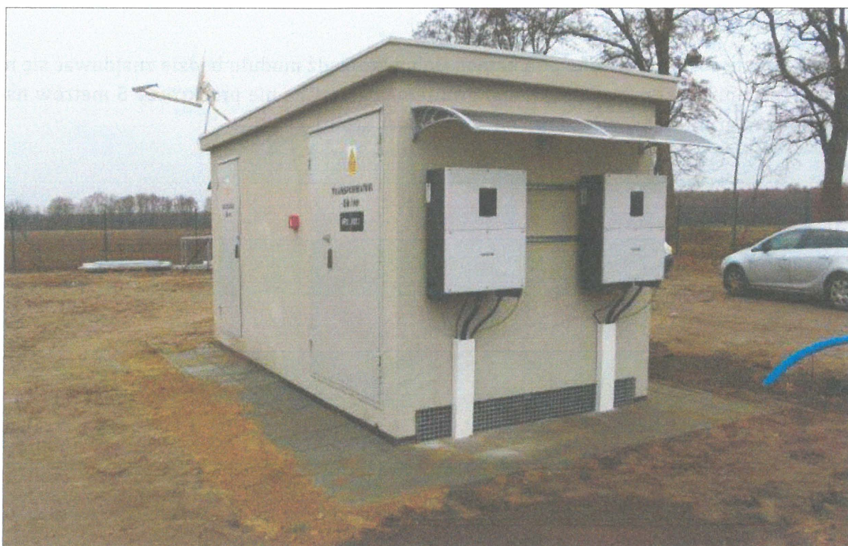
Rysunek 16 Falowniki zainstalowane na stacji transformatorowej SN
