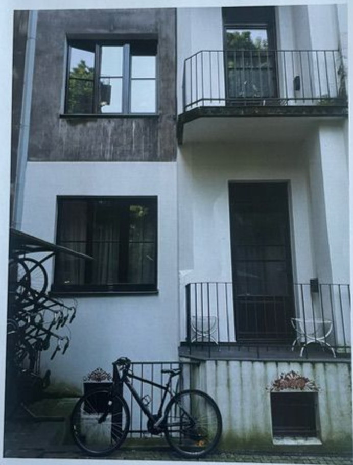
Fot. 5 kamienica przy ul. Mazowieckiej 3a w Krakowie. Elewacja tylna. Zawilgocenie partii grzywnienia.
