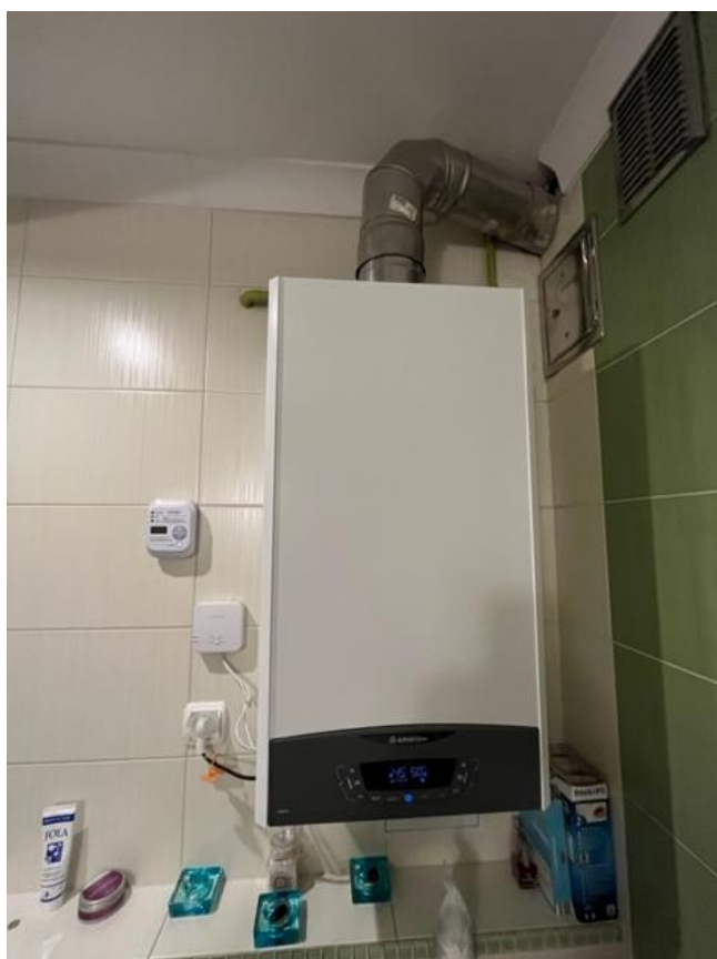
Rys. 6 Źródło ciepła – kocioł gazowy
