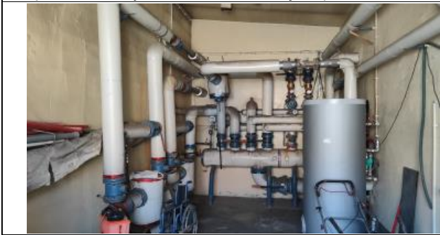
Ciepła woda użytkowa z osiedlowej ciepłowni
