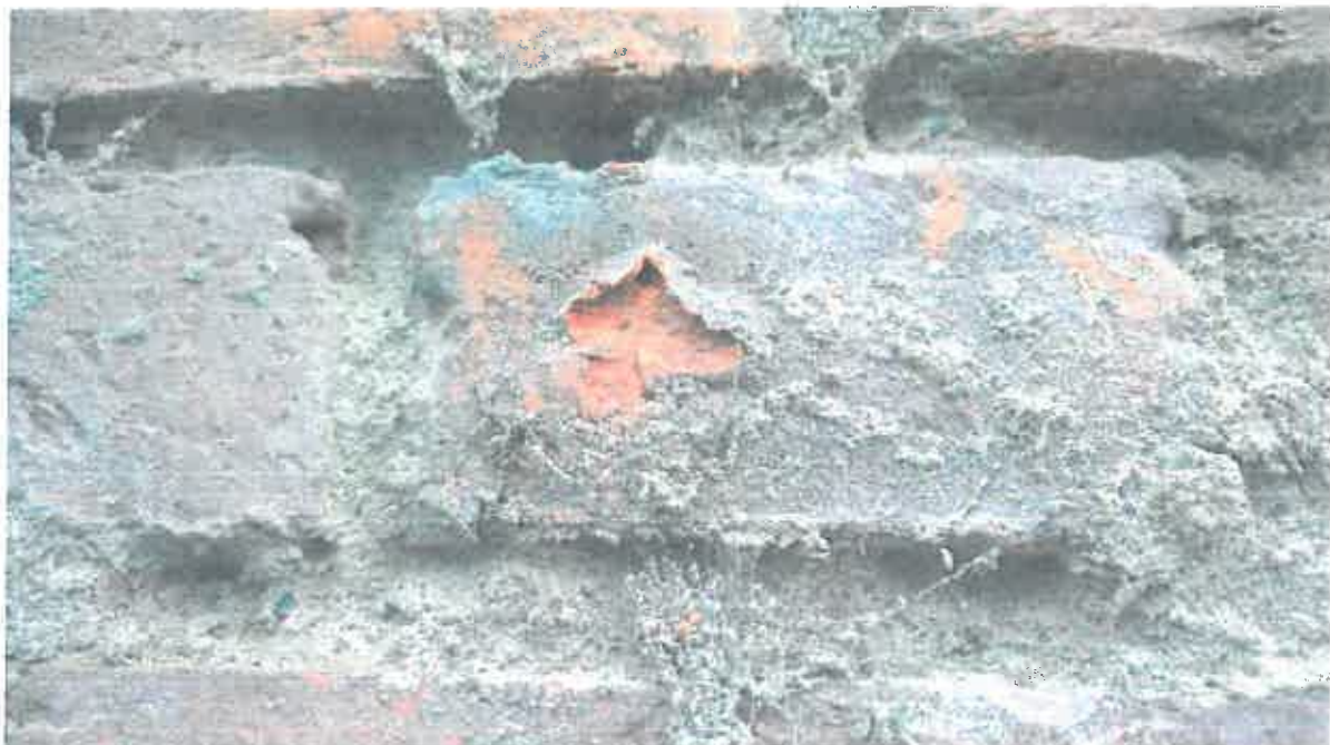
Zdjęcie 19 Zniszczenia budulca – łuszczenie się cegły; odsłonięty fragment – elewacja od strony podwórza.
