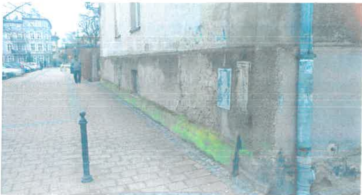
Zdjęcie 15 Cokół elewacji szczytowej biegnącej wzdłuż ul. Północnej; widoczny porost roślinności niskiej, zacieki i zabrudzenia.
