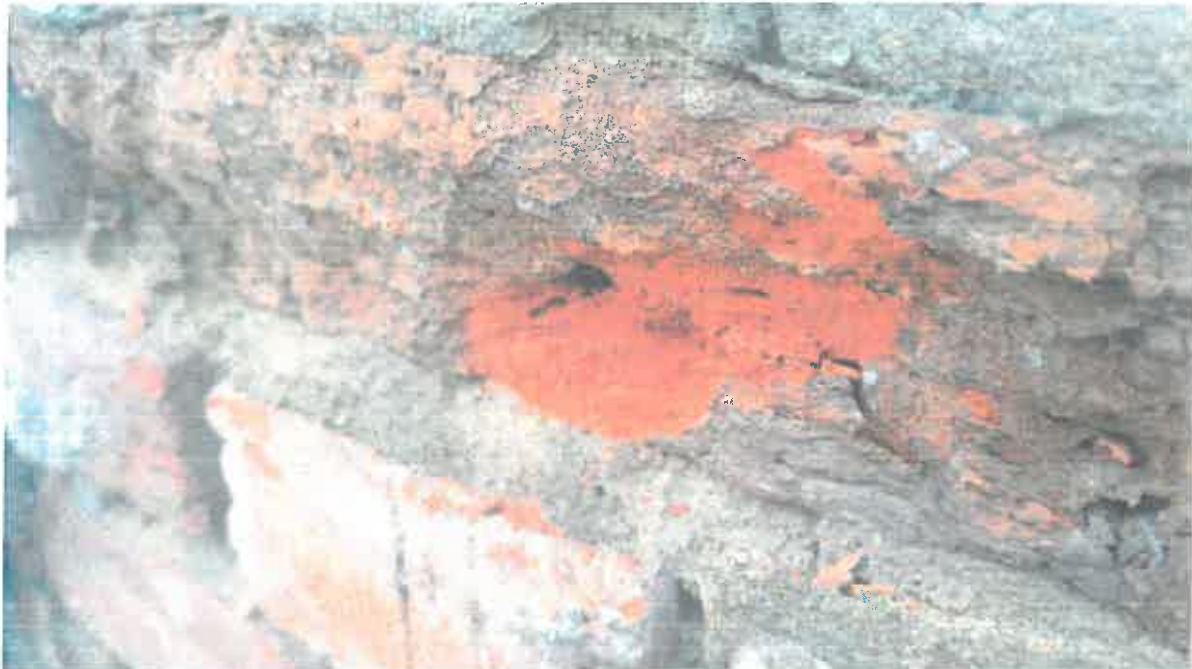
Zdjęcie 18 Zniszczenia budulca – łuszczenie się, kruszenie się cegły; odsłonięty fragment – elewacja frontowa.
