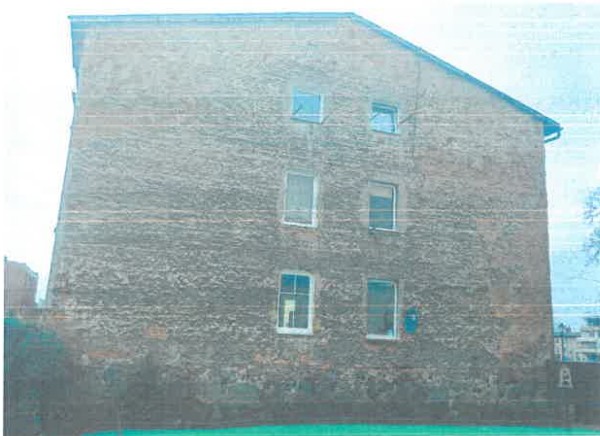
Zdjęcie 5 Elewacja szczytowa; dwuosiowa, wtórna stolarka okienna, wyprawa tynkarska w złym stanie, cokół z kamieni narzutowych granitowych.
