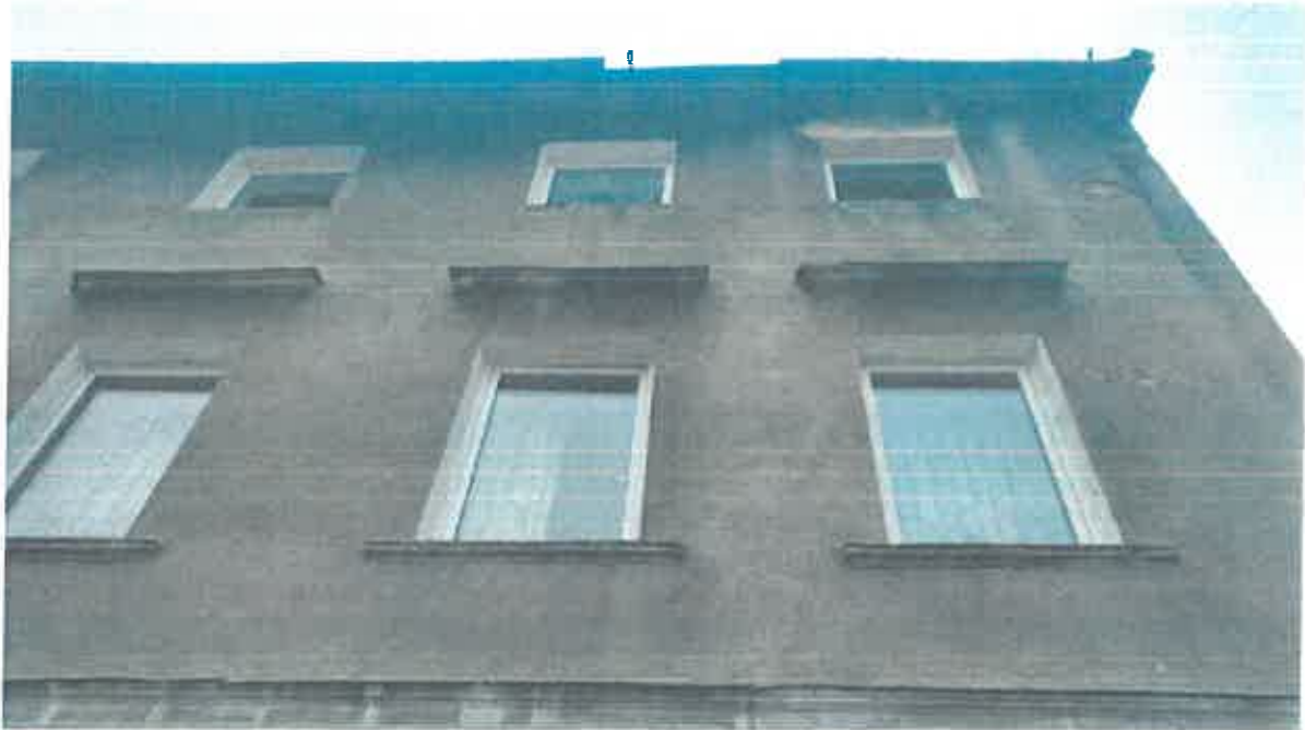
Zdjęcie 14 Fragment elewacji frontowej; Widoczne niepełne prynnowanie dachu oraz wtórne uzupełnienia krokwi dachu; widoczna wtórna stolarka z PVC – bez podziałów, jednoskrzydłowa; widoczne gzymsy nadokienne – zachowany fragment naczółków okiennych.
