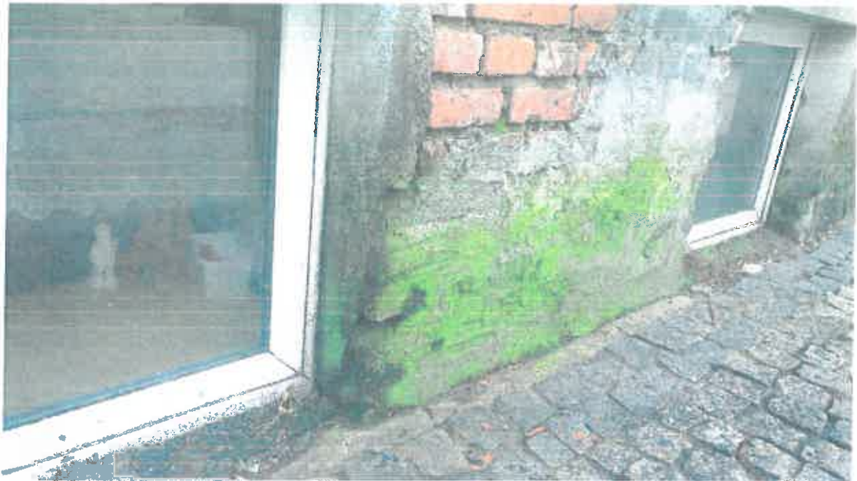
Zdjęcie 16 Partia przyziemia elewacji frontu; widoczna biokorozja, porost pleśni oraz roślinności niskiej; widoczne zniszczenia wyprawy tynkarskiej oraz lokalne naprawy.
