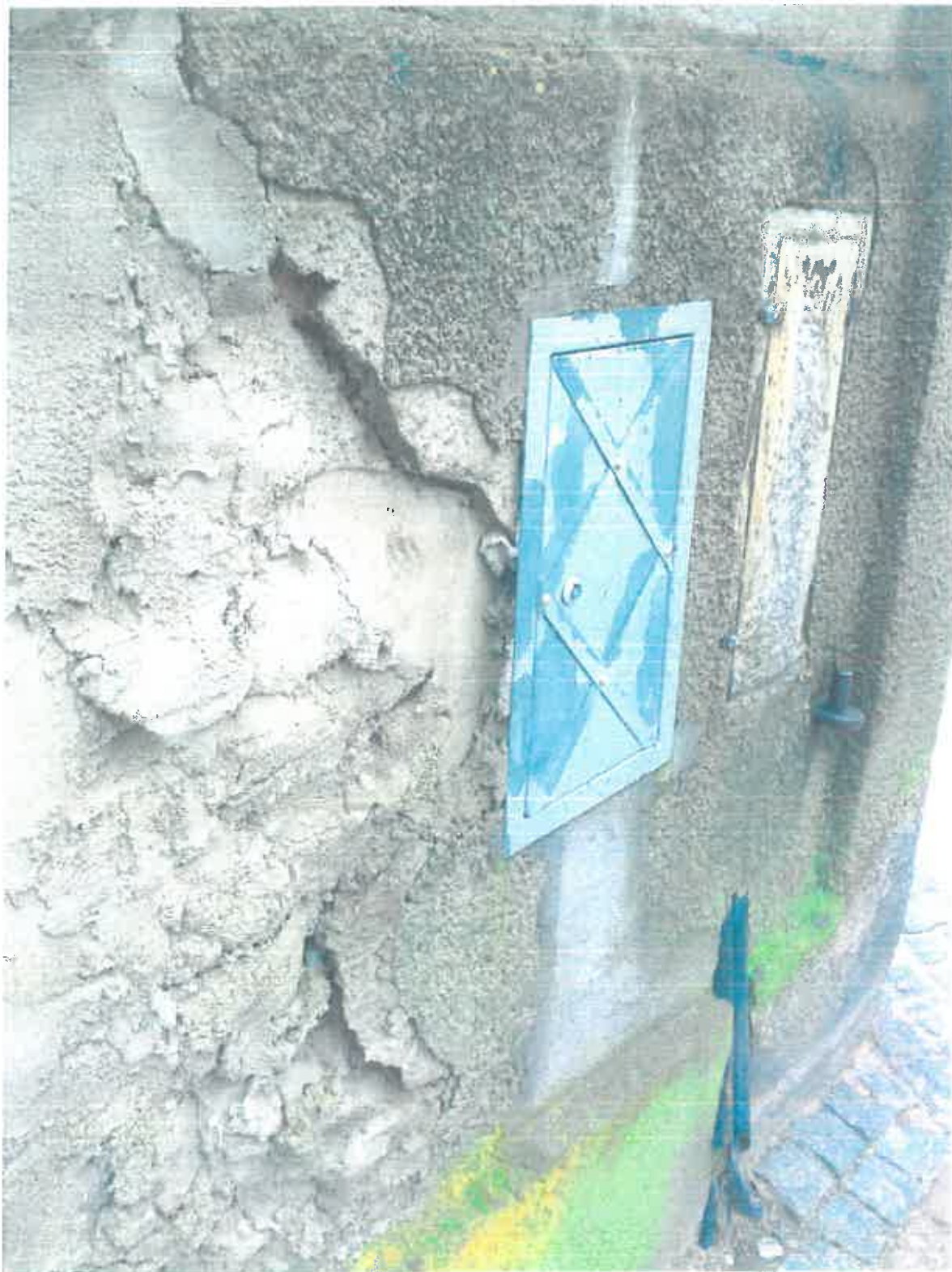
Zdjęcie 20 Fragment cokołu elewacji szczytowej – widoczna gruba wtórna warstwa wyprawy tynkarskiej oraz lokalne naprawy.
