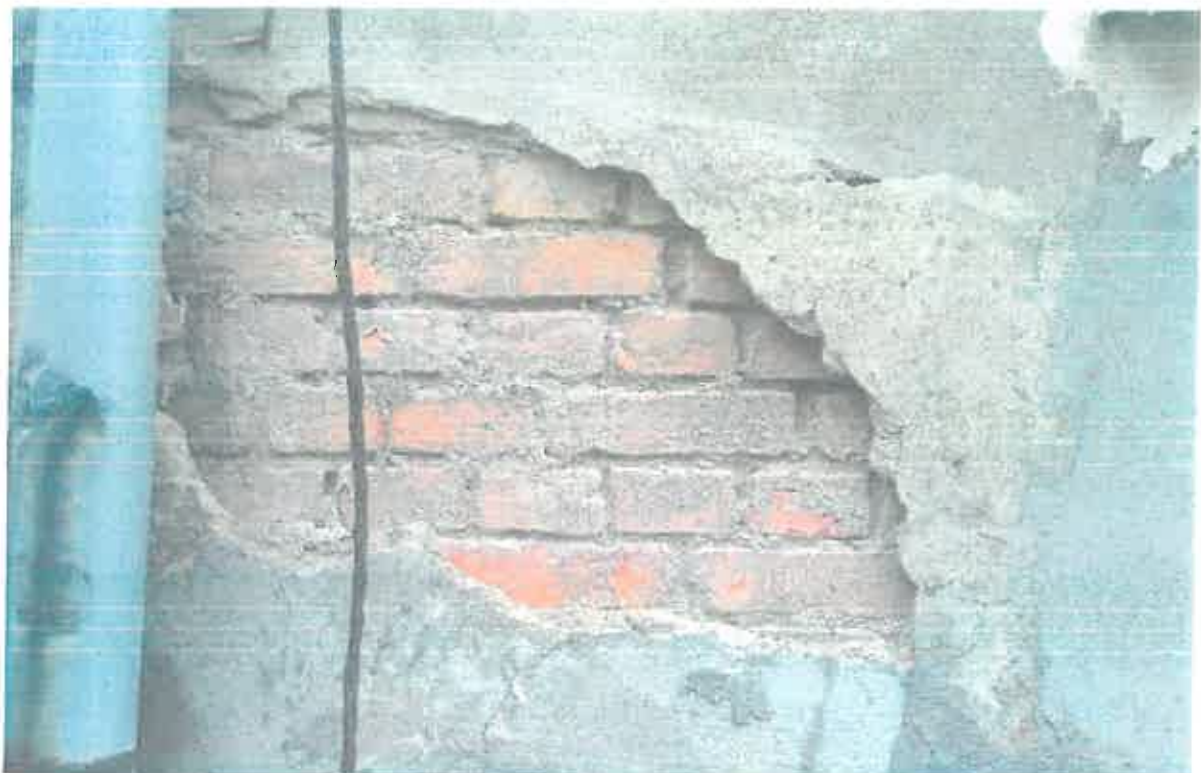
Zdjęcie 17 Zniszczenia wyprawy tynkarskiej w okolicy rury spustowej elewacji od strony podwórza.
